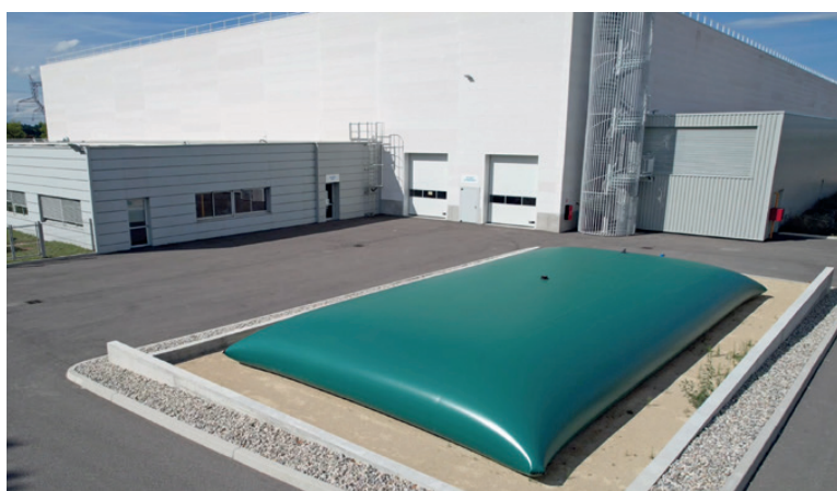
Cuve protection incendie
